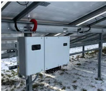
Foto - Udover solcellemodulerne består solcelleanlægget af invertere, som omdanner den producerede jævnstrøm til 230 volt vekselstrøm. Invertere placeres under solcellemodulerne sammen med under- og hovedtavler.
