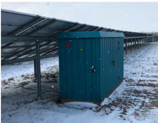
Foto - Eksempel på en teknikbygning, her en typisk transformerkiosk.
