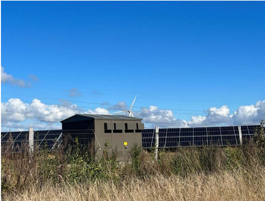
Figur 7. Step up transformer, som placeres på matriklens nordøstlige hjørne.
