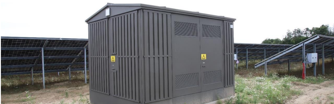
Billede 5: Solceller på stativer i baggrunden. Den hvide boks til højre er en inverter. I forgrunden ses en fordelingstransformer.
