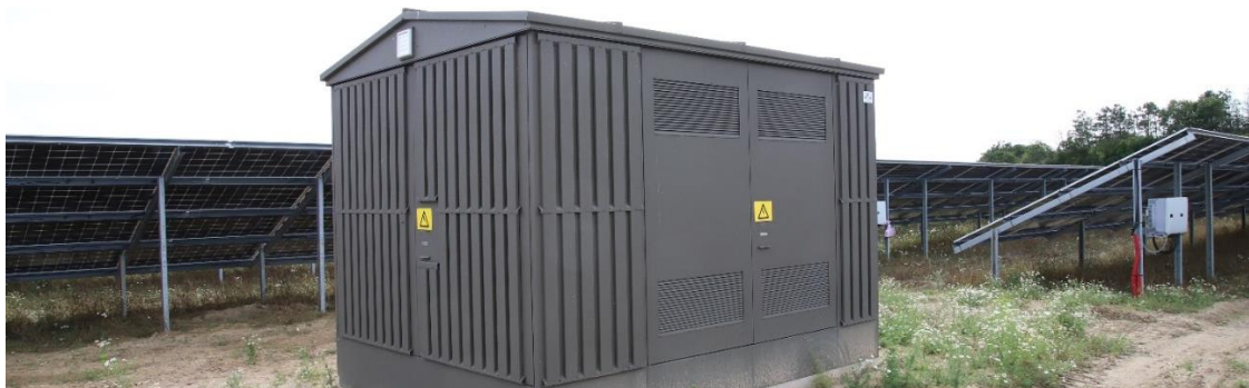
Billede 4: Solceller på stativer i baggrunden. Den hvide boks til højre er en inverter. I forgrunden ses en fordelingstransformer.
